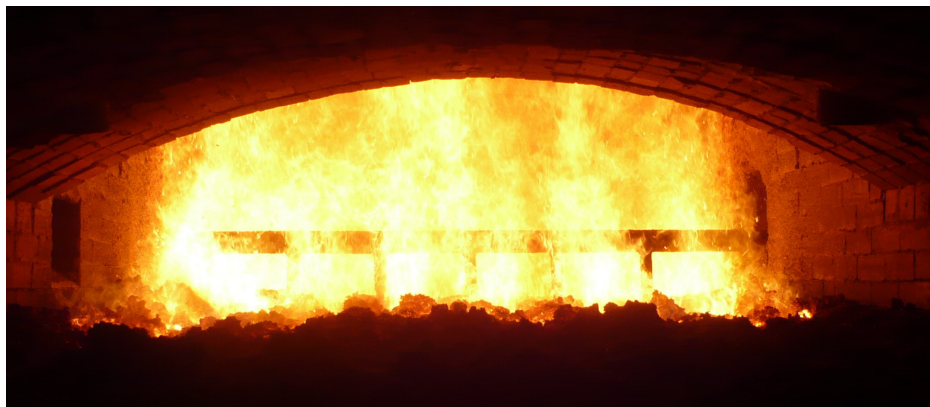
使用拨火机后锅炉炉膛主燃区的燃烧状况明显改善
