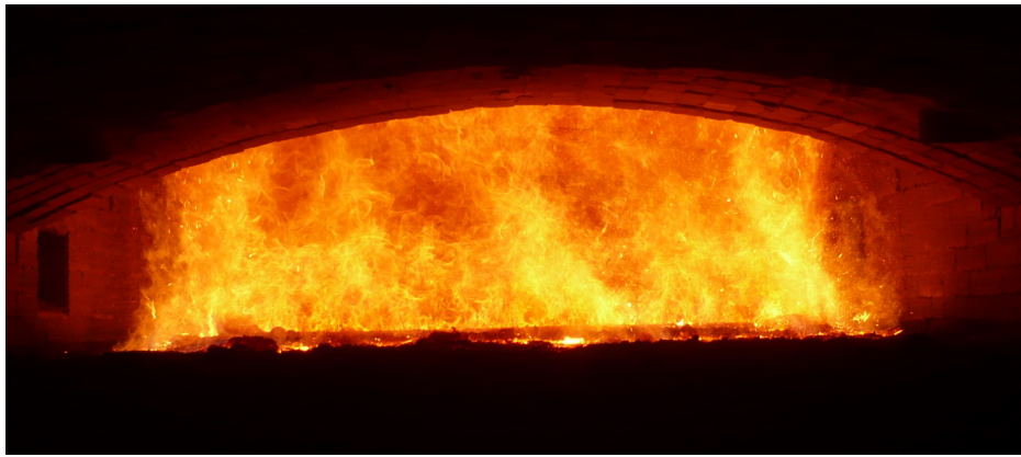
未使用拨火机前锅炉炉膛主燃区的燃烧状况
