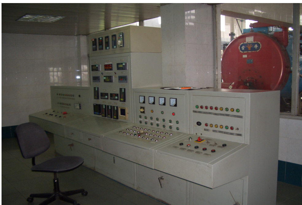
锅炉自动化控制室
