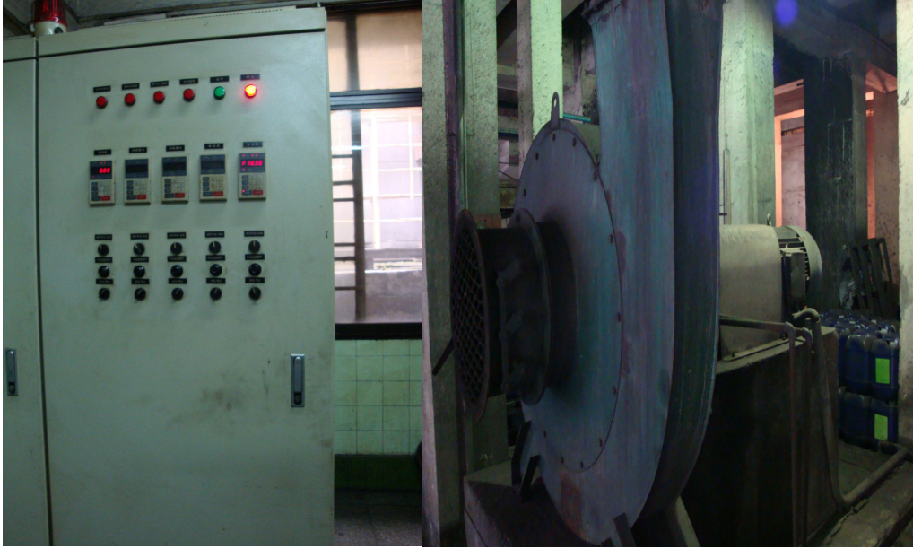
采用变频调速器控制锅炉鼓、引风机
