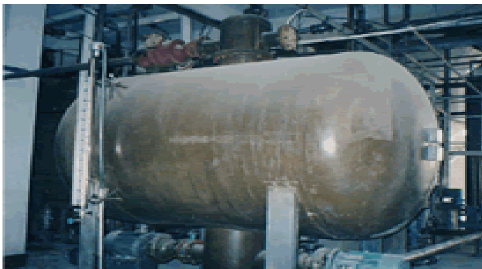
锅炉排污水回收装置
