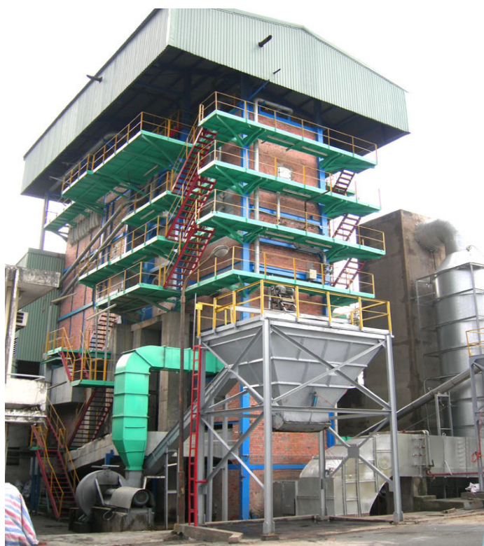
循环流化床锅炉
